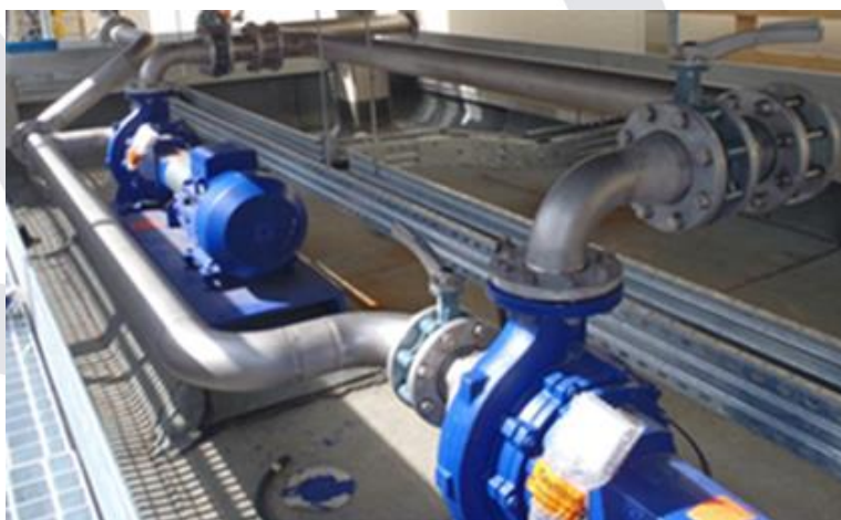
Verrohrung Werkstoff 1.4571 für einen Rückkühler
