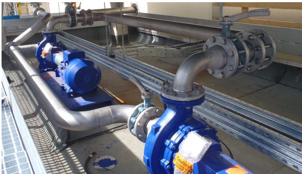
Rückkühlanlage Erdgasverdichter - Gasturbine
