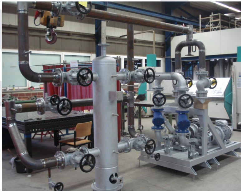
Vormontage einer Hydraulische Weiche und Pumpengruppe für ein Thermalölssystem
