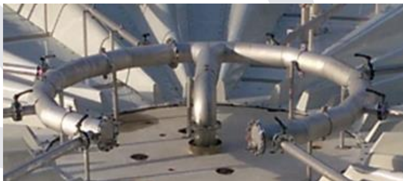
Abwasserreinigungsanlage eines Belebungsbeckens Rohrleitungswerkstoff 1.4571
