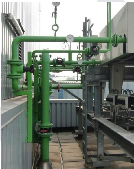
Verrohrung einer Rückkühlanlage
