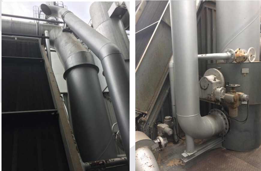
Rohrleitungen in DN 800 für die Wärmerückgewinnung
