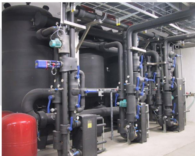
Kälteversorgung für eine Streichmaschine
