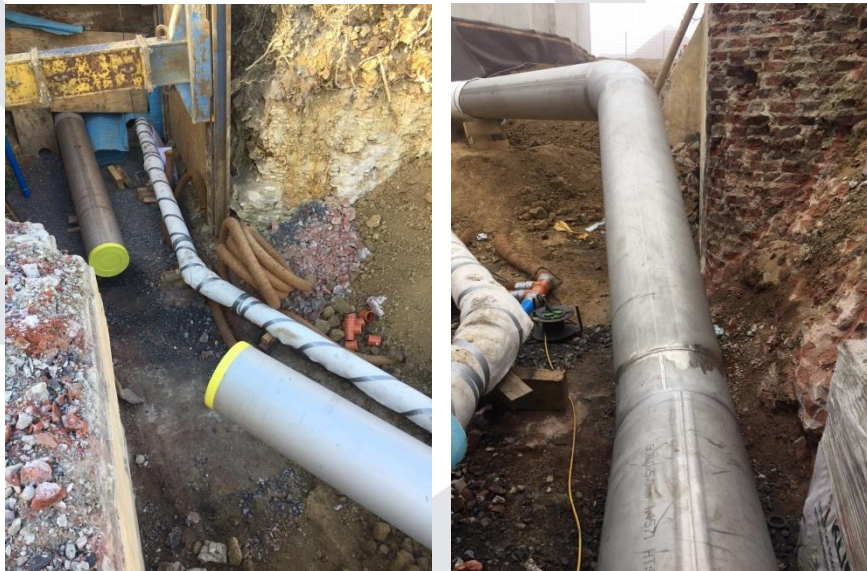
Trinkwasser Rohrleitung DN500 508 x 5,0 Werkstoff 1.4571
