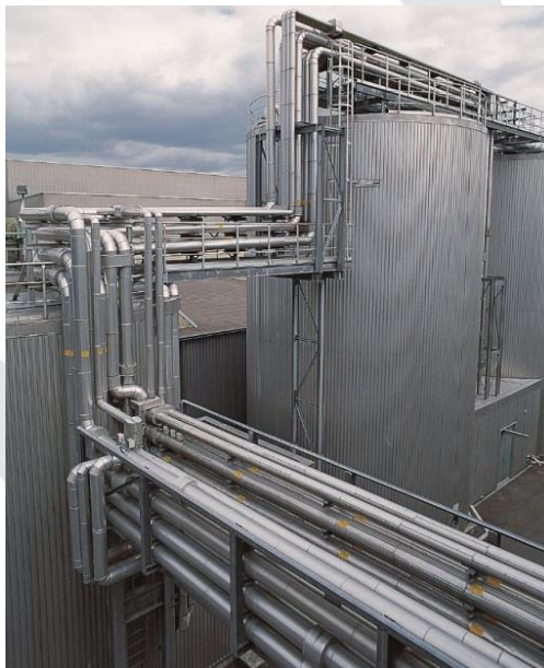
Isolierte Versorgungsrohrleitungen, Werkstoff 1.4571 für eine Pigmentaufbereitung
